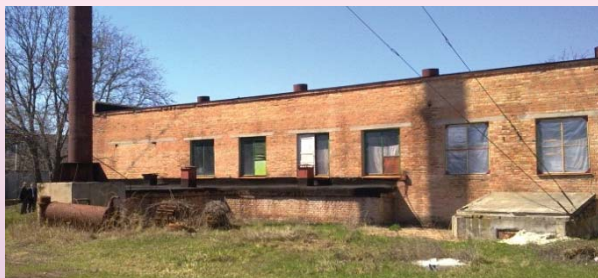
Рисунок 1 – Пілотна опалювальна котельня ОКВПТГ «Миргородтеплоенерго»
